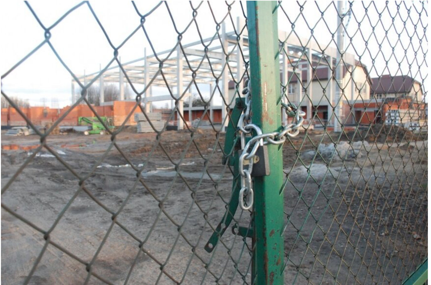
Budowa hali stanęła. Kto ją dokończy? (fot. Beata Pierzchała)
