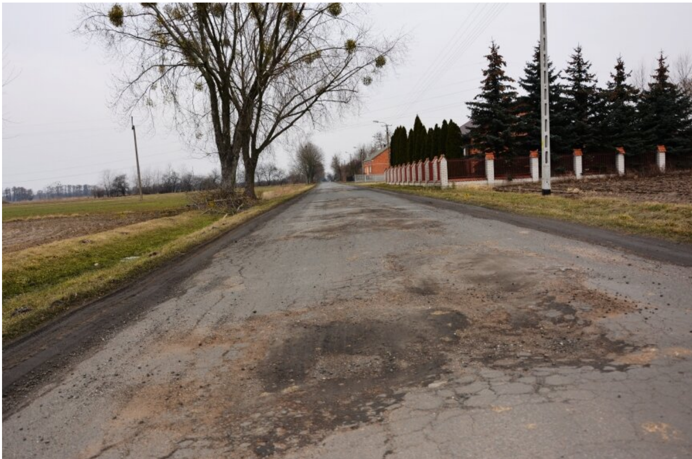
Droga powiatowa w Kurabce została zniszczona przez ciężkie samochody dojeżdżające do modernizowanej linii kolejowej. (fot. Beata Pierzchała)
